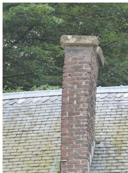
rood - scheefstaande schoorsteen
