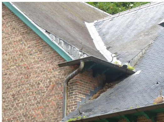
ontbrekende leien aan de dakrand en lekken aan de kilgoot
