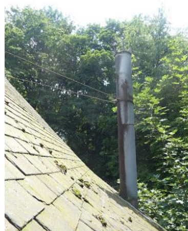
verweerde zinken schoorsteen met ontbrekende afdekkap
