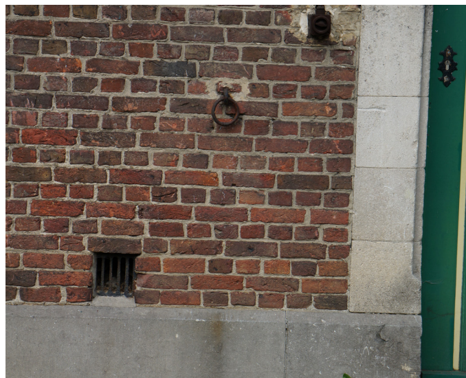
Afbeelding 15. Aan de gevel van de stalling bevinden zich nog ringen waar de dieren aan werden vastgebonden. Bron: Erfgoed en Visie
