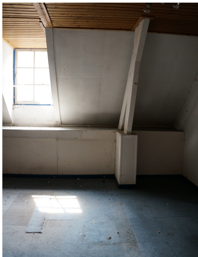
Afbeelding 42. K1.05 met vals plafond en recente wand- en vloerafwerking. Bron: Erfgoed en Visie
