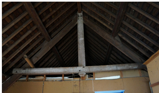
Afbeelding 39. Spantconstructie op de zolder van het koetshuis, gezien vanuit K1.02. Bron: Erfgoed en Visie
